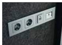
Anschlüsse in der Kabine
